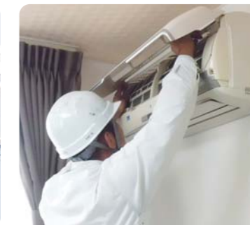
壁掛けエアコン
