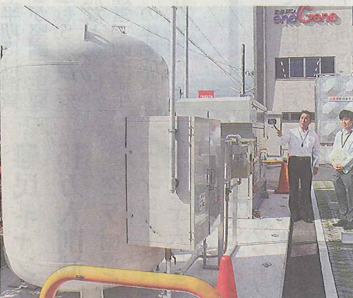
敷地内に設けたLPガスの貯槽や非常用発電機＝浜松市中区高林のエンネジン本社で
