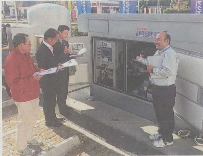
災害用のLPガス発電機を見学する人たち 浜松市中区で
