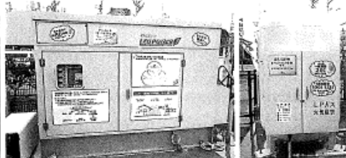
LPガス発電機
